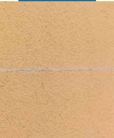
Старая облицовка с трещинами
